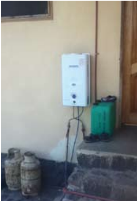
B. TANQUES DE GAS Y CALENTADORES DE AGUA EN UNA ENTRADA CREAN CONDICIONES PELIGROSAS EN CASO DE INCENDIO.
