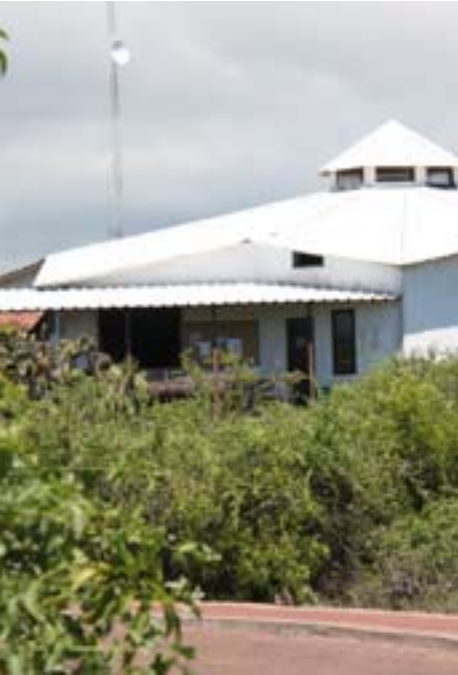
C. LOS EDIFICIOS PARA VISITANTES CARECEN DE CUIDADO, CON TECHO DAÑADO, NECESIDAD DE PINTAR Y CABLES ELÉCTRICOS EXPUESTOS.
