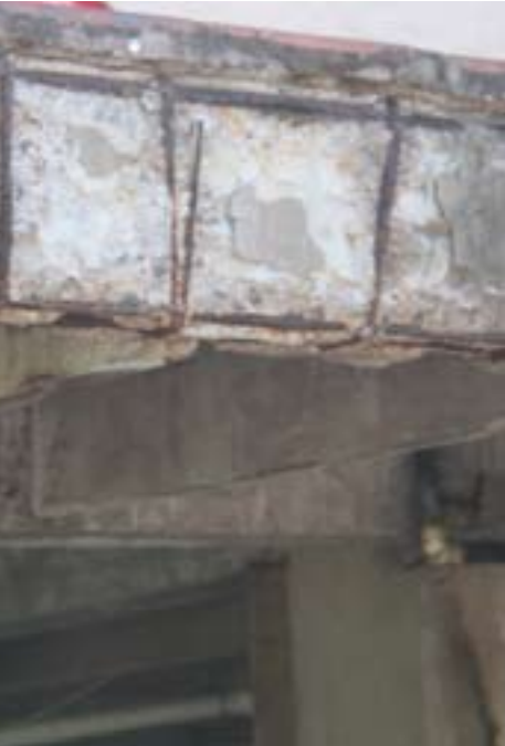
D. EJEMPLO DE MALA CONSTRUCCIÓN, LA LOSA DE LOS DORMITORIOS FRANKFURT ESTAN EN RIESGO DE COLAPSAR EN EL FUTURO..
