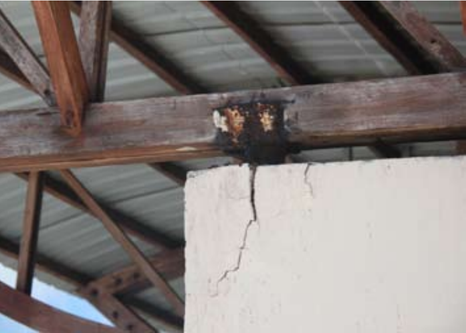
C. SOPORTES DE ACERO HAN SIDO DAÑADOS POR LA FALTA DE MANTENIMIENTO. LA OXIDACIÓN HAN CAUSADO QUE LAS PAREDES SE QUIEBREN, LO QUE EXPONE LOS ELEMENTOS ESTRUCTURALES AL AIRE.
