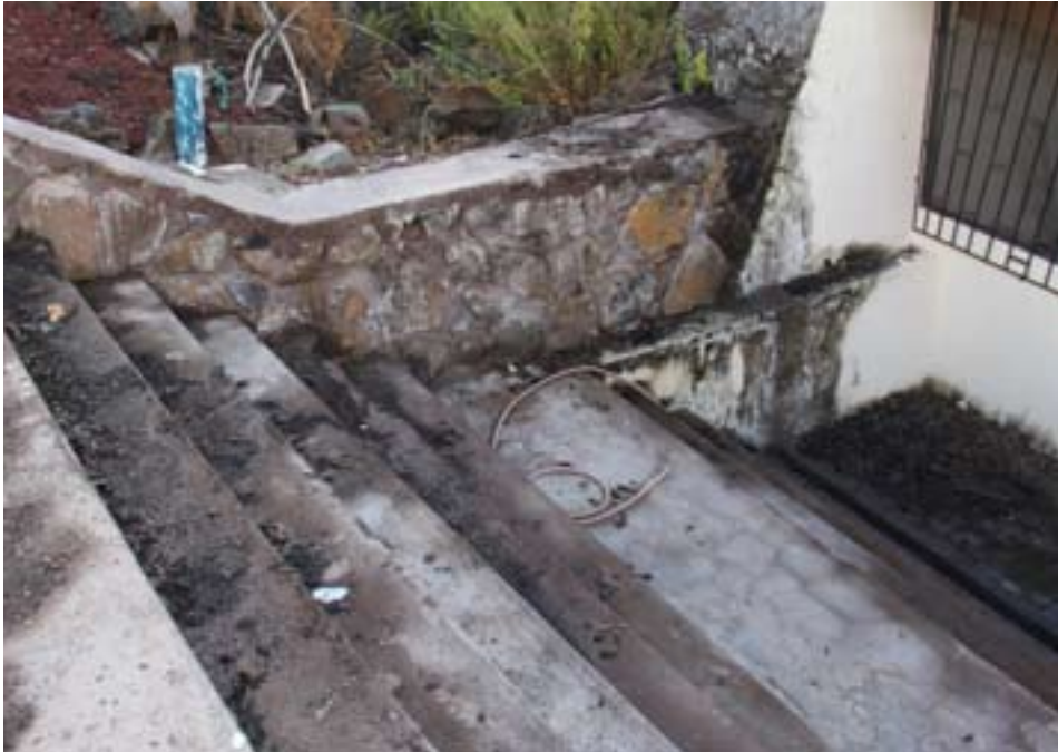
A. ÁREAS MAL DISEÑADAS Y CONSTRUIDAS SIRVEN COMO TRAMPAS DE AGUA Y ACUMULACIÓN DE MOHO EN EDIFICIOS.
